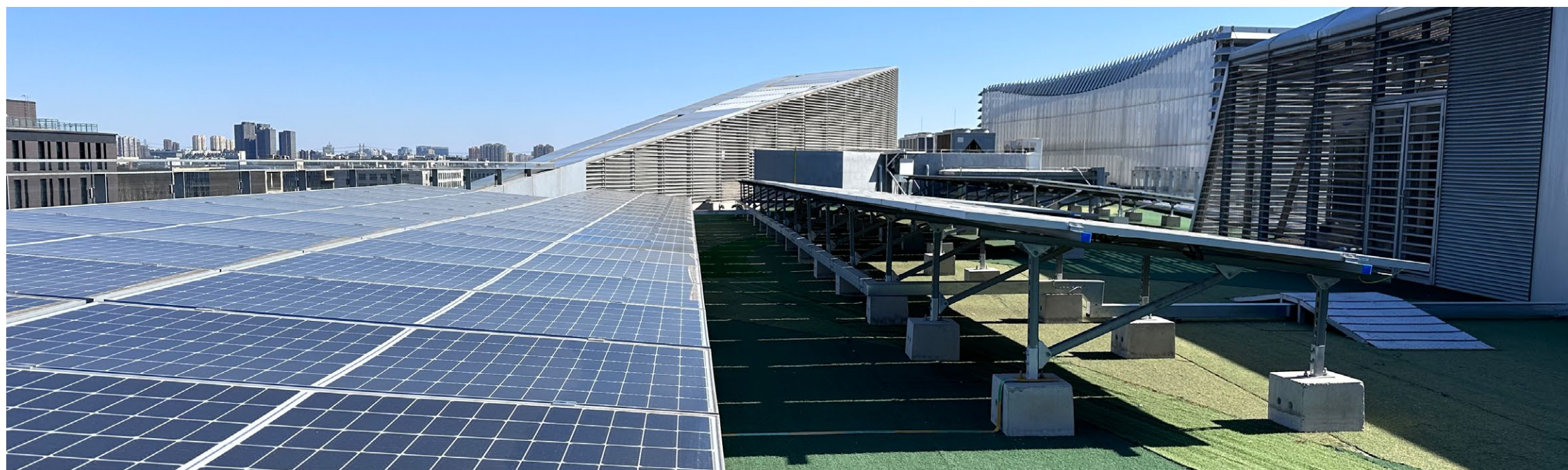
自建数据中心光伏图片
